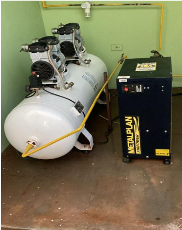
Rede de Ar comprimido
